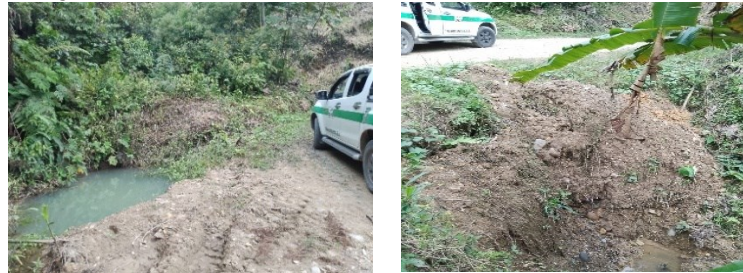
IMAGEN 34.- FALTA DE DRENAJE TRANSVERSAL EN VIALIDAD RURAL, PATUCA. Fuente: Información levantada en campo por el equipo consultor PDOT 2024. Elaboración: Equipo Consultor PDOT 2024.
