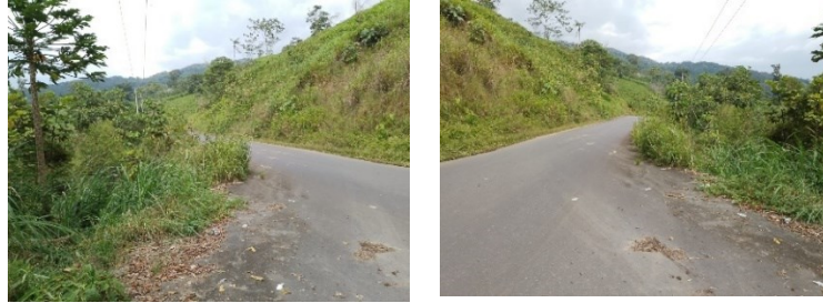
IMAGEN 33.- SOCAVACIONES PRESENTES EN LA VIA ASFALTADA (E40), PATUCA. Fuente: Información levantada en campo por el equipo consultor PDOT 2024. Elaboración: Equipo Consultor PDOT 2024.
